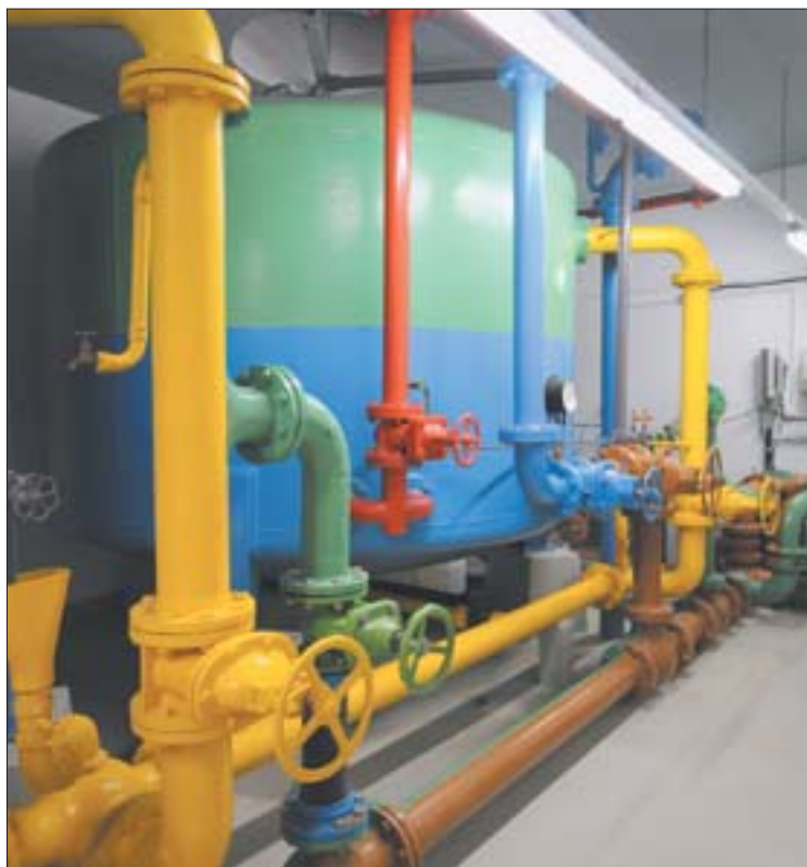
Blick ins Weggiser Seewasserpumpwerk.
