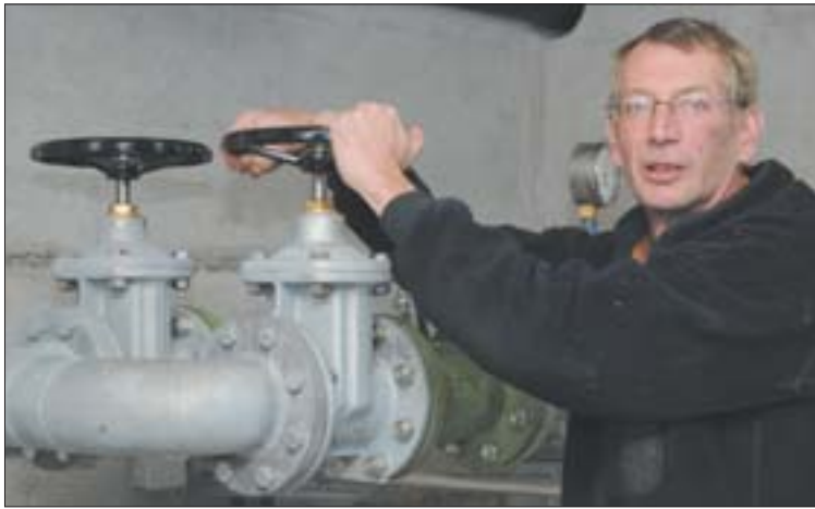
Der Grepper Brunnenmeister Otto Odermatt beim «Schiebern» im Grundwasserpumpwerk Riedhof.
